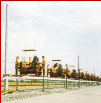
Neubau Schnellbaustrecke mit UWG. Vorziehen der Hilfsbahn und Absetzen des 180 Meter langen „Joches“
